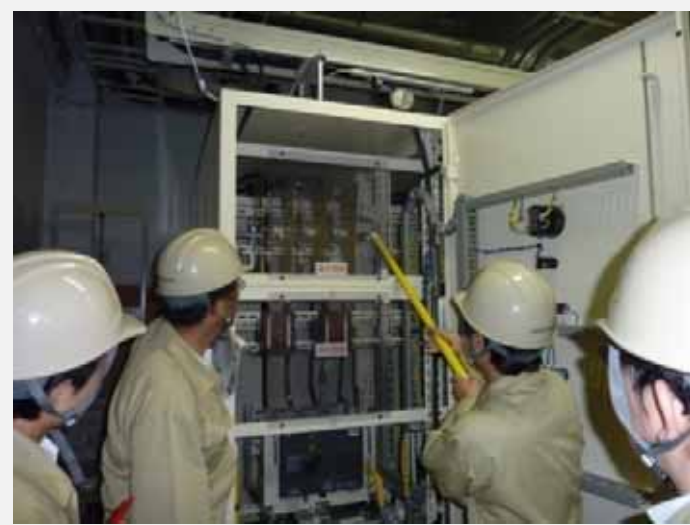
受変電機器の種類と役割
