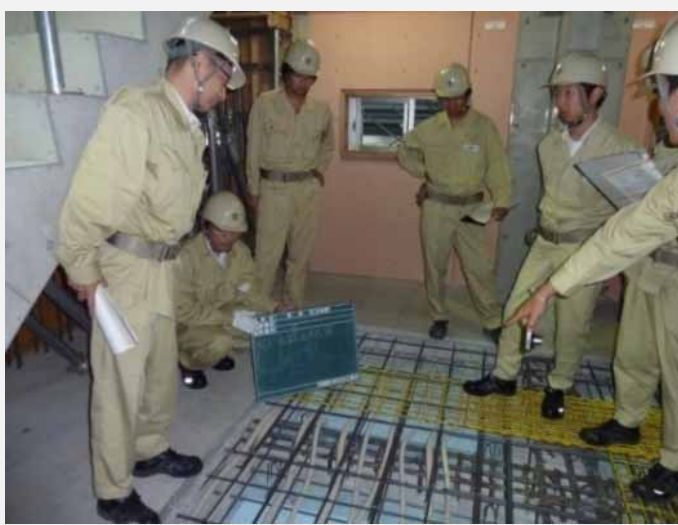
建築構造の基礎、配管の間違い確認
