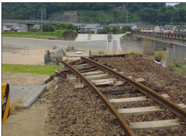
H29 年 7 月 九州北部豪雨の被害
