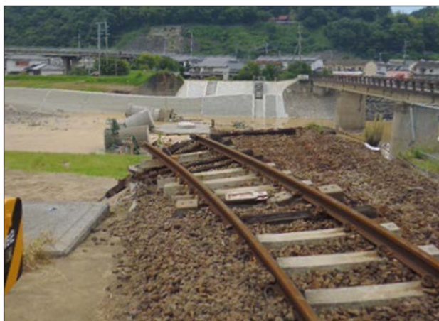
H29 年 7 月 九州北部豪雨の被害
